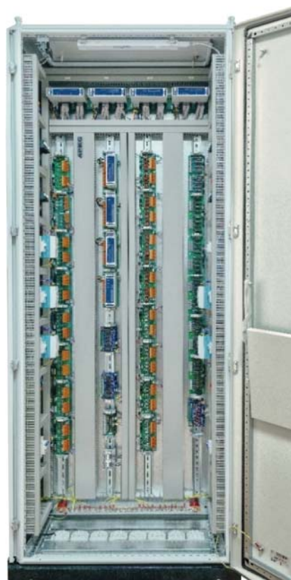
Рис. 1. Контроллерный шкаф ШК МИРТС
