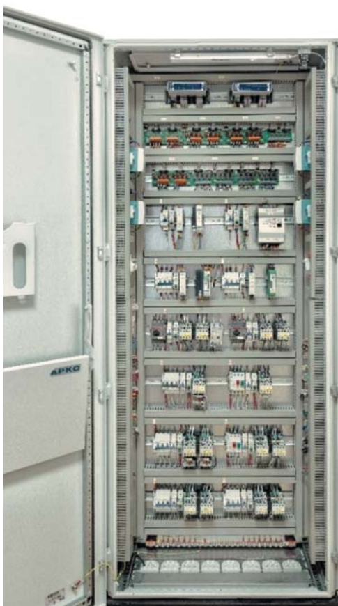
Рис. 3. Интеллектуальный шкаф НКУ МИРТС
